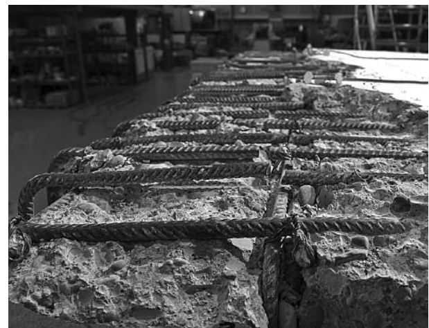
Gebrochene Bewehrungsstäbe in der Rahmenecke Ost. Fractured reinforcing bars in the eastern frame corner.
