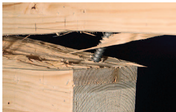
Versagen der Verstärkung auf Ausziehen führt zu einem gutmütigen Tragverhalten des ausgeklinkten Trägers. Pull-out failure of the reinforcement leading to ductile failure of the notched beam.
