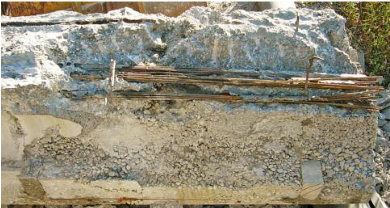
Kiesnester und schlecht injizierte Spannglieder bei einem der vier 4.70 x 1.00 m grossen Segmente, die aus der Brücke gesägt wurden.
