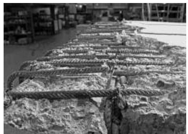
Gebrochene Bewehrungsstäbe in der Rahmenecke Ost. Separated reinforcing bars at the eastward corner of the frame.
