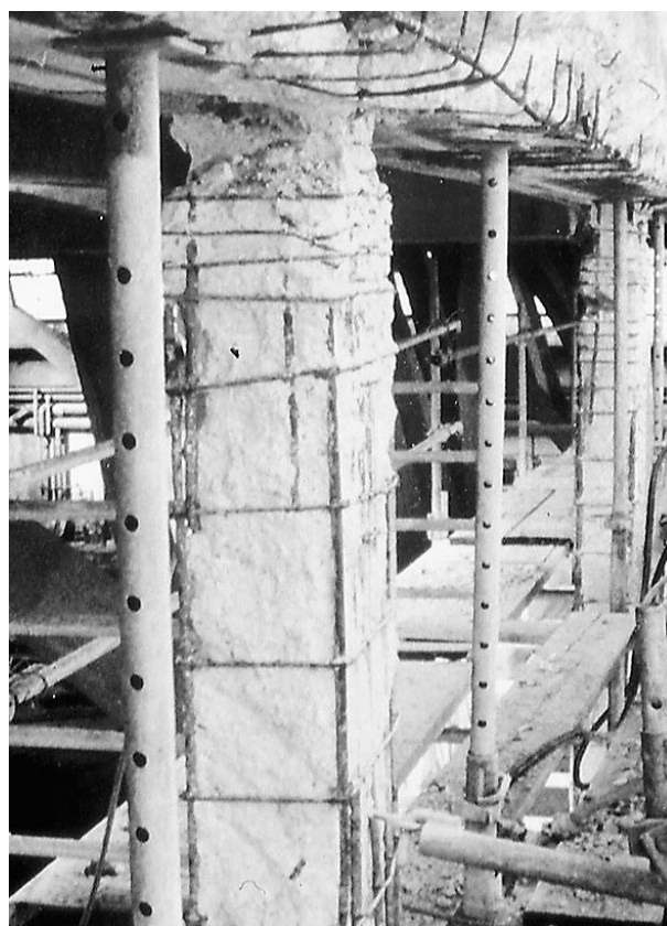
Abplatzungen von Beton im Brandfall. Spalling of concrete due to a fire.
