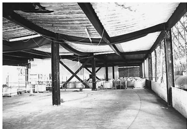
Verformte Deckenkonstruktion mit ungeschützten Stahlträgern. Deformed slab with unprotected steel beams.
