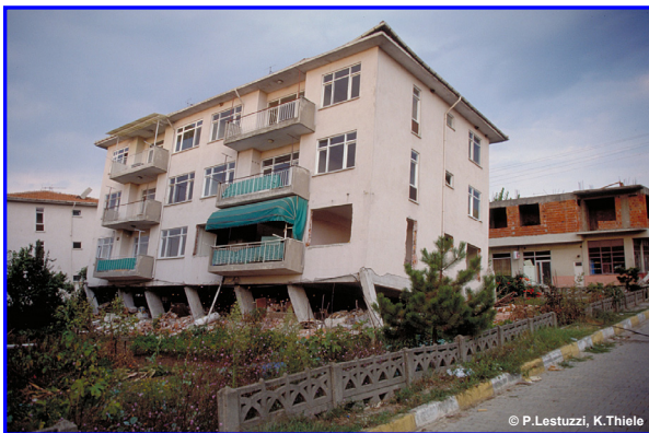
Soft-Storey (Kocaeli Erdbeben, 1999)
